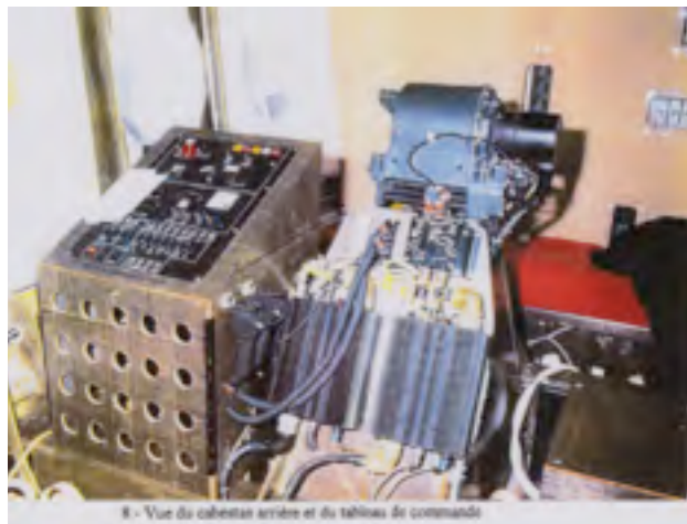
8 - Vue du cabinet arrière et du tableau de commande
